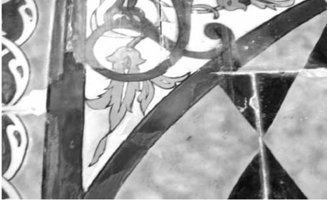
Resim 7: Atmosfer koşulları nedeniyle çini yüzeylerde meydana gelen bozulmalar.
