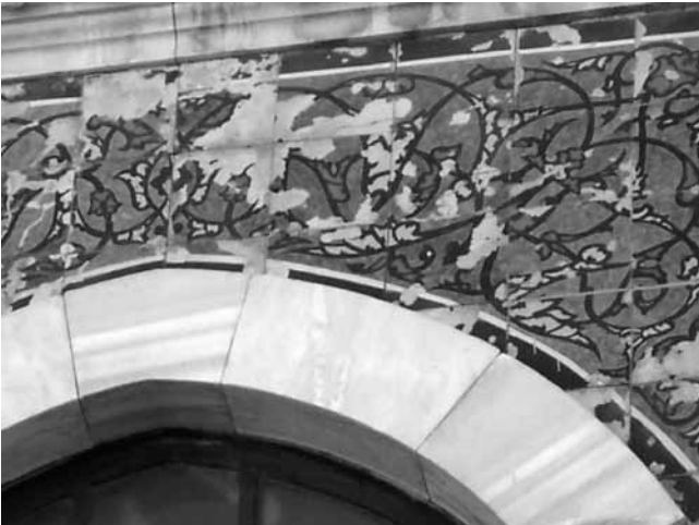
Resim 5: Atmosfer koşulları nedeniyle çini yüzeylerde meydana gelen bozulmalar.
