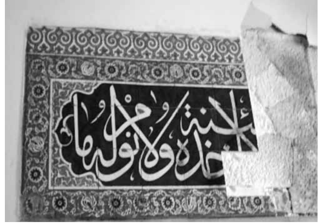
Resim 8: Sismik hareketlenmeler sonucu plaka kenarlarında kaplamalar veya yüzeyden ayrılarak dökülmeler gözlenmektedir.
