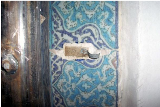
Fotoğraf-79: Çinilere monte edilmiş ahşap ve demir parçaları (Melik Ahmet Paşa Camii, Diyarbakır).
