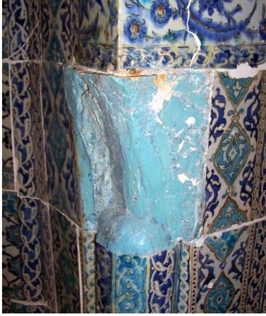
Fotoğraf-93: Mihrap Sütun başlığı onarım öncesi (Melik Ahmet Paşa Camii, Diyarbakır).
