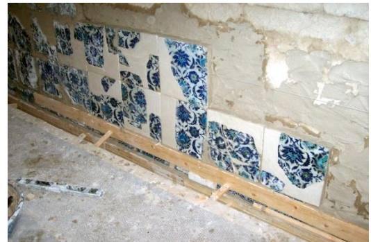
Fotoğraf-110: Onarılan çinilerin monte aşaması (Doğu Cephesi) (Melik Ahmet Paşa Camii, Diyarbakır).
