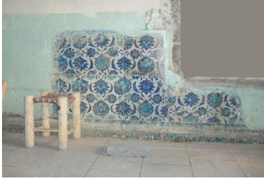
Fotoğraf-133: Batı Cephesi çinileri restorasyon öncesi, detay (Melik Ahmet Paşa Camii, Diyarbakır).
