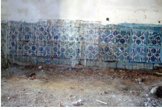
Fotoğraf-127: Doğu Cephesi çinileri restorasyon öncesi, detay (Melik Ahmet Paşa Camii, Diyarbakır).
