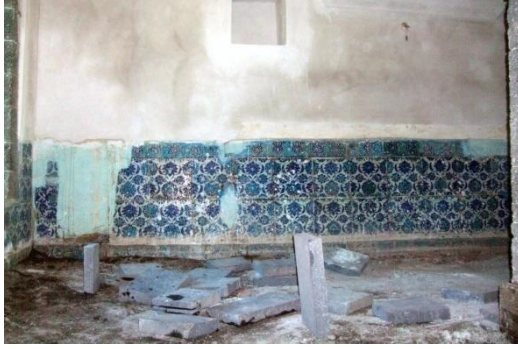
Fotoğraf-135: Batı Cephesi çinileri restorasyon öncesi, detay (Melik Ahmet Paşa Camii, Diyarbakır).
