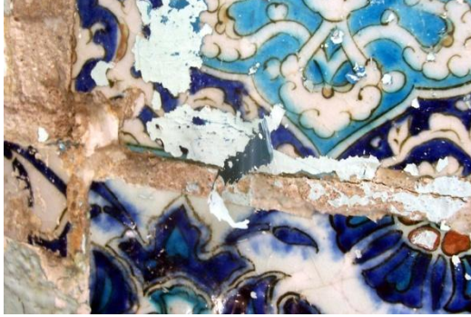
Fotoğraf-73: Çini yüzeylerdeki yağlıboya kalıntıları (Melik Ahmet Paşa Camii, Diyarbakır).
