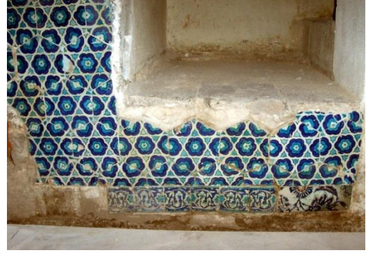
Fotoğraf-68: Mahfil merdiven eşiği çinileri kimyasal temizlik sonrası (Melik Ahmet Paşa Camii, Diyarbakır).
