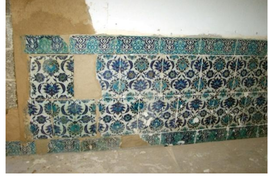
Fotoğraf-112: Çinilerin monte işlemi sonrası (Güney Cephesi) (Melik Ahmet Paşa Camii, Diyarbakır).
