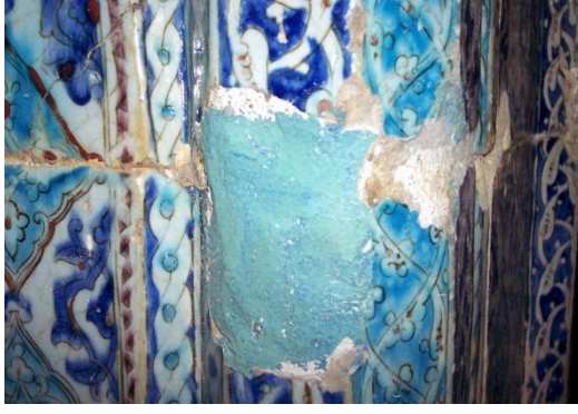
Fotoğraf-71: Mihrap çinilerindeki hasarlı alana uygulanmış çimento katkılı harç ve yağlı boya kalıntısı (Melik Ahmet Paşa Camii, Diyarbakır).
