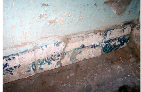
Fotoğraf-48: Doğu Cephesi çinileri, Restorasyon öncesi (detay) (Melik Ahmet Paşa Camii, Diyarbakır).
