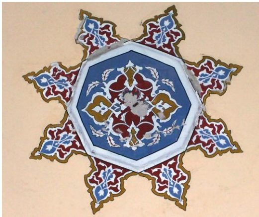
Fotoğraf-19: Sıva üstü kalem işleri restore edildikten 10 yıl sonra görülen bozulmalar (İstanbul-Kadırga Sokollu Mehmed Paşa Camii son cemaat revakı kubbe göbeği).
