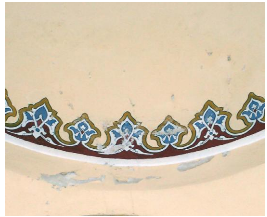
Fotoğraf-20: Sıva üstü kalem işleri restore edildikten 10 yıl sonra görülen bozulmalar (İstanbul-Kadırga Sokollu Mehmed Paşa Camii son cemaat revakı kubbe eteği).
