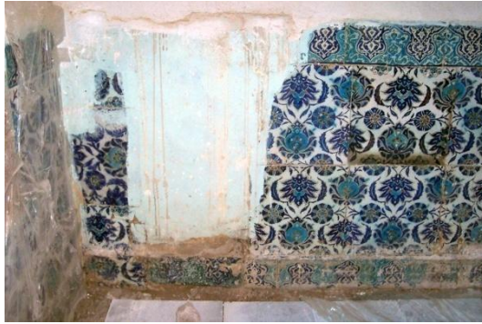
Fotoğraf-51: Batı Cephesi çinileri, Restorasyon öncesi (detay) (Melik Ahmet Paşa Camii, Diyarbakır).
