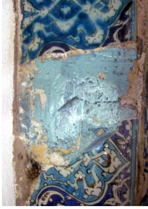
Fotoğraf-55: Mihrap bordür çinilerindeki hasarlı kısım (çimento katkılı harç ve yağlı boya kalıntısı) (Melik Ahmet Paşa Camii, Diyarbakır).
