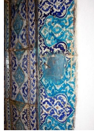
Fotoğraf-57: Mihrap bordür çinilerindeki hasarlı kısım (çiniye monte edilmiş ahşap parçası, çivi ve yağlı boya kalıntısı) (Melik Ahmet Paşa Camii, Diyarbakır).
