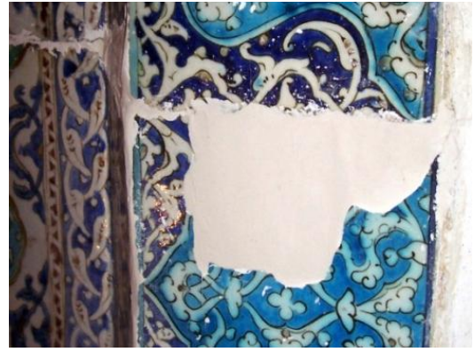
Fotoğraf-90: Hasarlı alanın onarım sonrası (Mihrap çinileri bordür alanı) (Melik Ahmet Paşa Camii, Diyarbakır).
