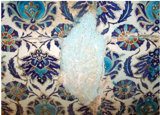
Fotoğraf-75: Batı Cephesi çinilerinin hasarlı alanındaki çimento katkılı harç kalıntısı (Melik Ahmet Paşa Camii, Diyarbakır).
