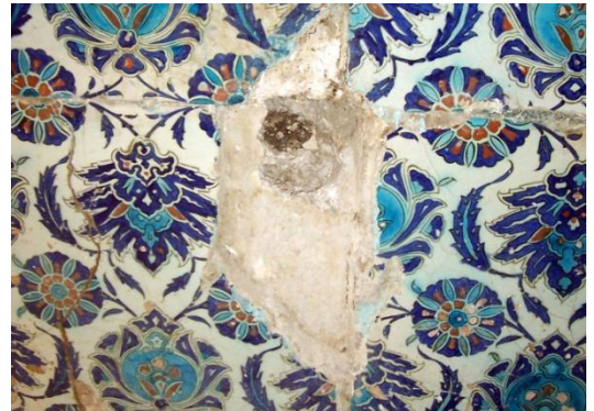
Fotoğraf-76: Batı Cephesi çinilerinin hasarlı alanındaki çimento katkılı harç kalıntısının mekanik temizlik sonrası (Melik Ahmet Paşa Camii, Diyarbakır).
