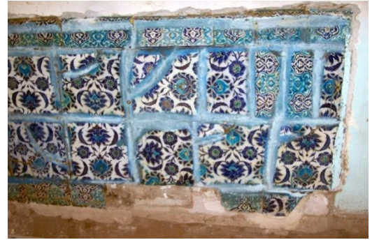
Fotoğraf-66: Doğu Cephesi çinileri genel temizlik sonrası (Melik Ahmet Paşa Camii, Diyarbakır).
