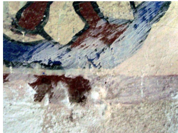
Fotoğraf-144: Mihrap sıva üstü kalem işleri bozulma detayı (Diyarbakır, Melik Ahmet Paşa Camii).
