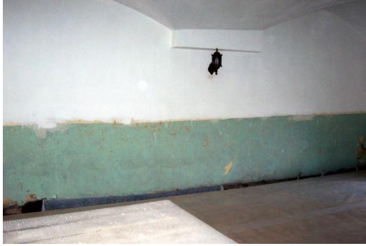
Fotoğraf-85: Geri dönüşümsüz çimento katkıli harçla sıvanmış alan (Doğu Cephesi) (Melik Ahmet Paşa Camii, Diyarbakır).
