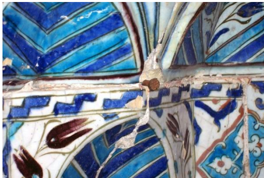
Fotoğraf-53: Mihrap mukarnas çinileri arasına monte edilmiş zararlı unsurlar (çivi) (Melik Ahmet Paşa Camii, Diyarbakır).
