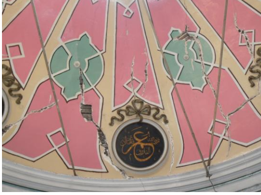
Fotoğraf-23: İzmir İkiçeşmelik Camii kubbesi sıva üstü kalem işleri restorasyon öncesi durumu.
