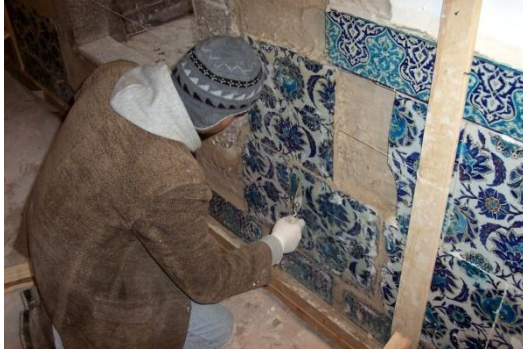
Fotoğraf-111: Onarılan çinilerin monte aşaması (Güney Cephesi) (Melik Ahmet Paşa Camii, Diyarbakır).
