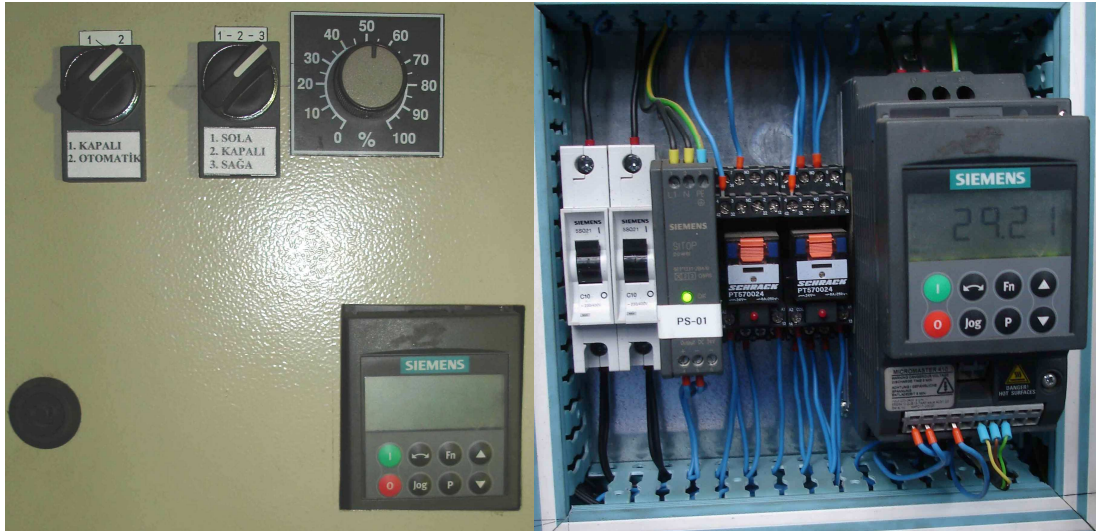
Şekil 14.2 Elektrik panosu ön ve iç görünümü.
