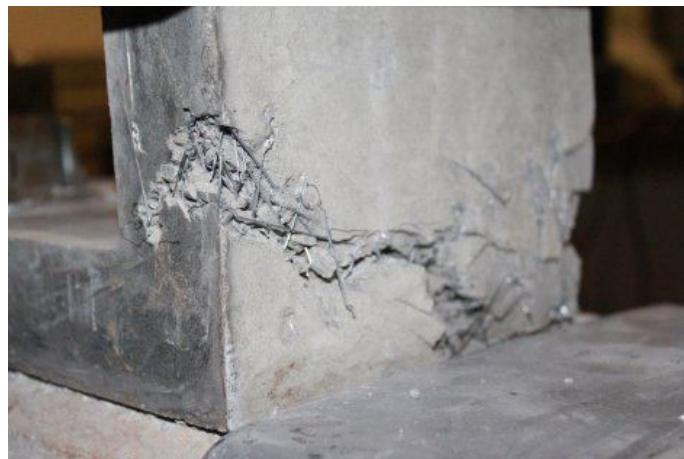
Şekil 2.41 S4 numunesinin % 7,4 ötelenmedeki hasar durumu.
