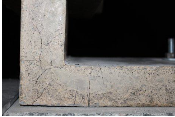
Şekil 2.40 S4 numunesinin % 2,4 ötelenmedeki hasar durumu.
