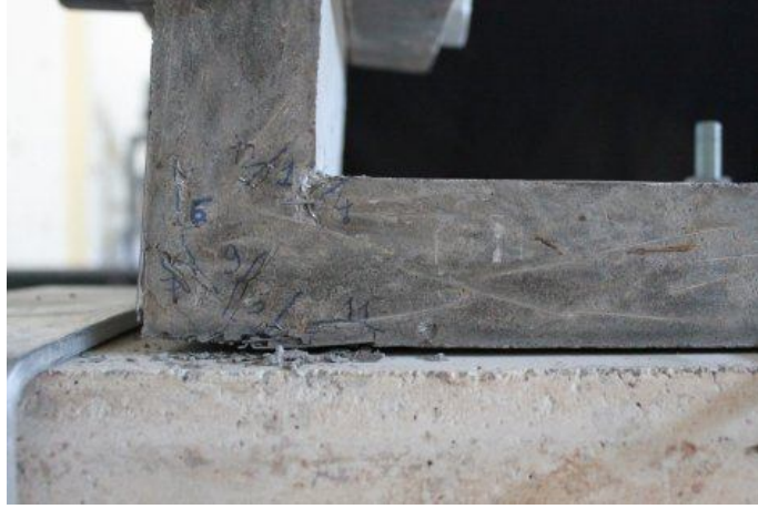
Şekil 2.35 S3 numunesinin % 3,6 ötelenmedeki hasar durumu.
