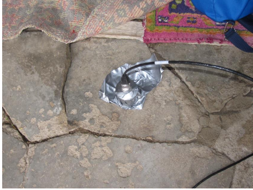
Şekil 3.33 Sensörlerin yere sabitlenmesi ve yüzeydeki çatlaklar
