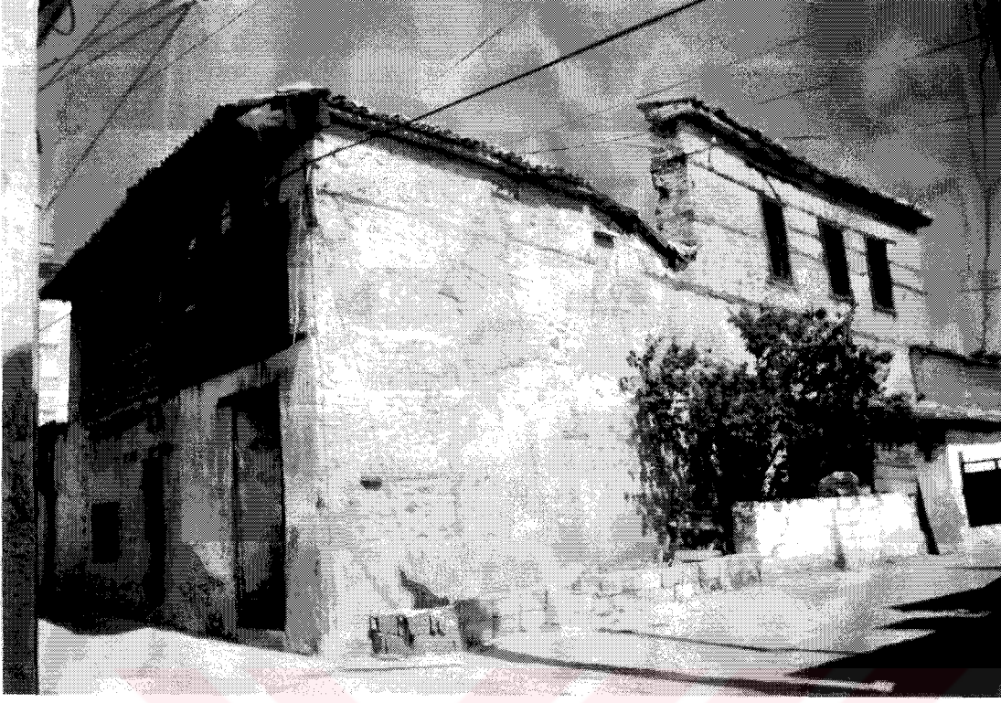
Şekil 4.8 Yıkılmış Tarihi Bir Ev
