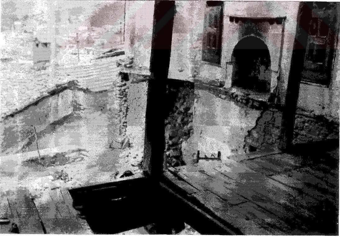
Şekil 4.9 Yıkılmış Tarihi Bir Ev
