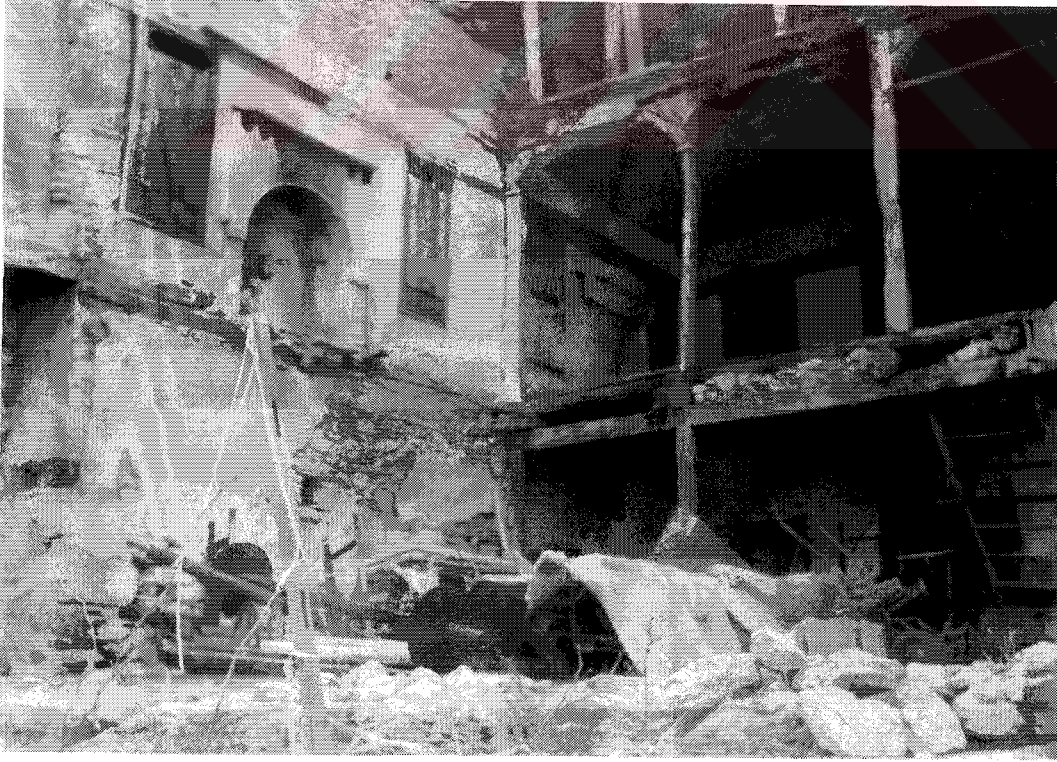
Şekil 3.114 Şazuman Bey Evi Cephesi, Sol Kanat Yıkıldıktan Sonra
