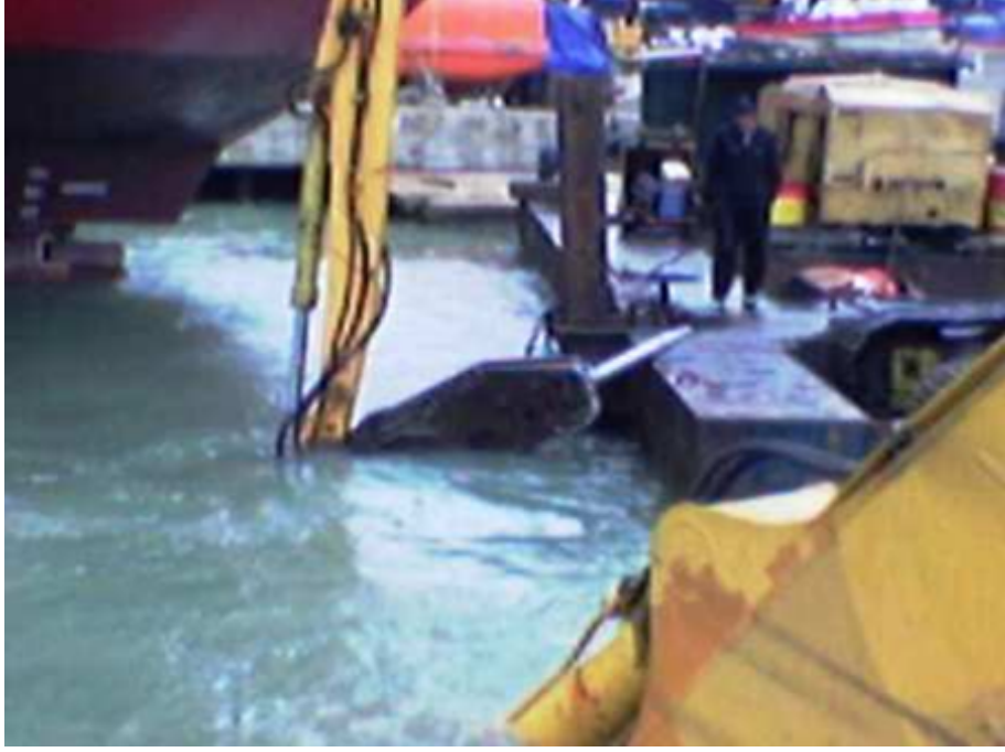
Şekil 2.3 Çok sıkı zeminde veya çatlaklı kayada kırıcı ile yapılan bir çalışma (Yurder, 2005).
