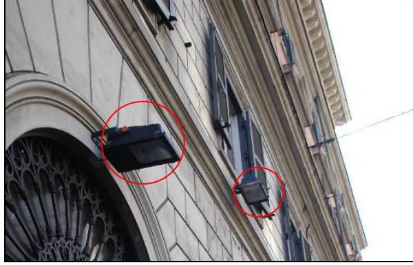
Şekil 4.55 Zemin kattaki dükkanların aydınlatılmasına dair bir örnek
