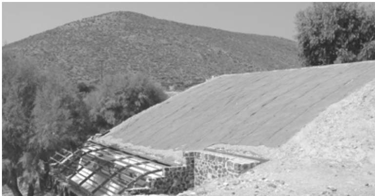
Şekil 3.15 Çatının volkanik tüf ile kaplanması (tamamlanmış pilot uygulama), Eylül 2003, (Doumas ve Fintikakis, 2007).
