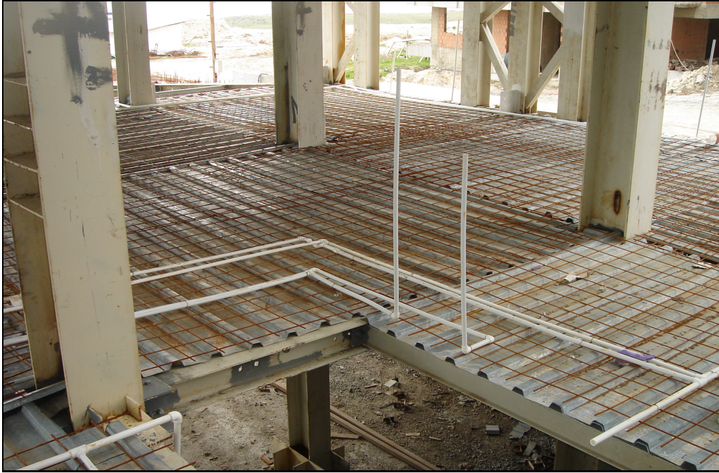
Şekil 4. 10 Temiz su tesisatının yerleşimi ve tesisat iniş boşluğu (İstanbul Beylikdüzü, 30/03/2008).
