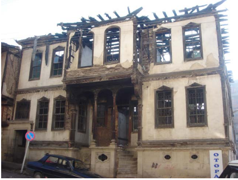
Şekil 5.5 Çıkan yangın sonucu hasar görmüş bir yapı
