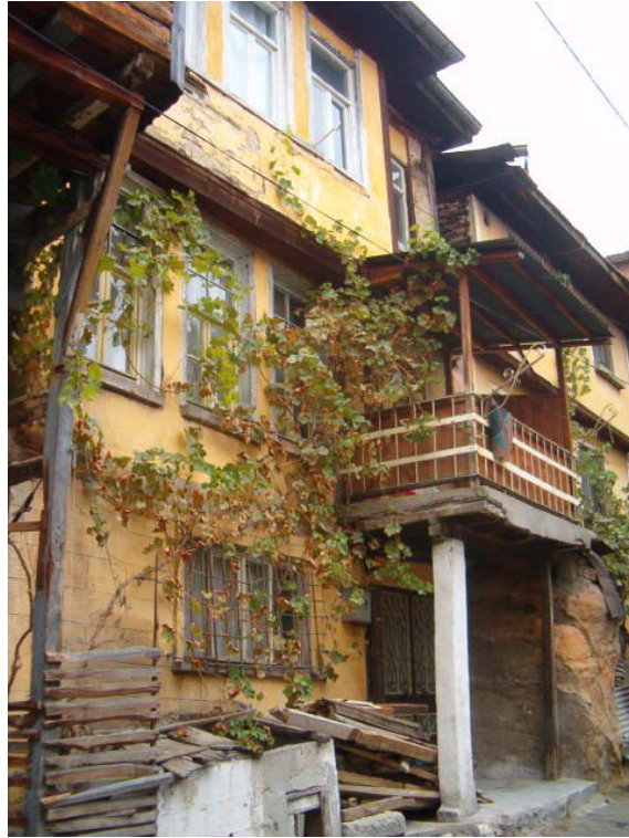
Şekil 5.2 Yapıya getirilen yeni ek sonucu cephede görülen bozulma
