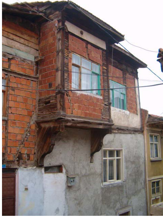
Şekil 5.1 Yapının özgün yapısına aykırı teknik ve malzeme kullanımı
