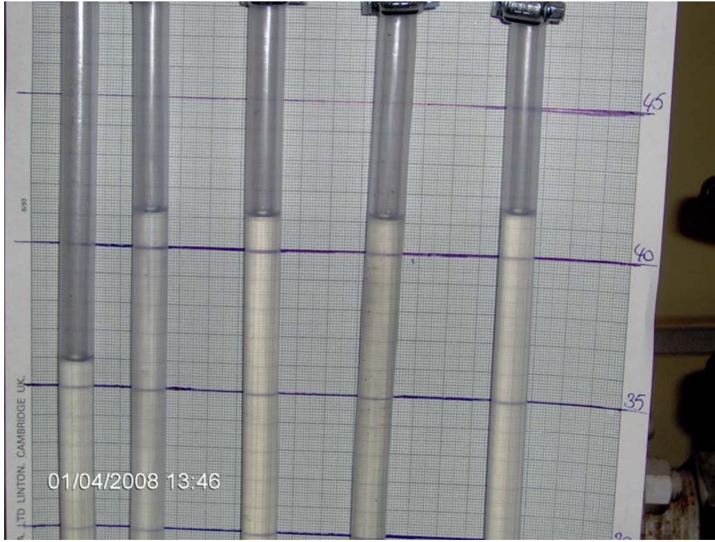
Şekil 3.17 Piyezometre borularının yer aldığı pano.
