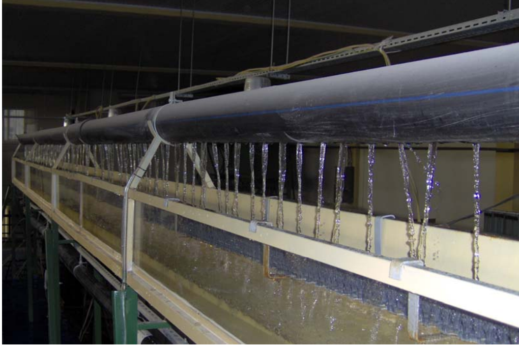
Şekil 3.2 Yağmur suyu toplama kanalı.
