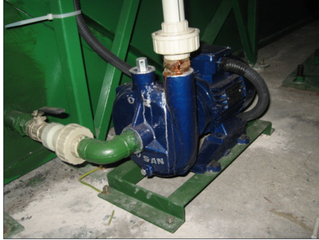
Şekil 4.7 Feyezan verme deposuna su sağlayan pompa
