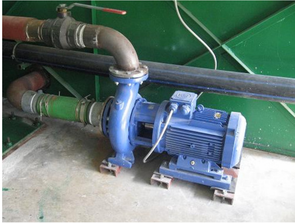
Şekil 4.3 18,5 Kw gücünde pompa ve küresel vana
