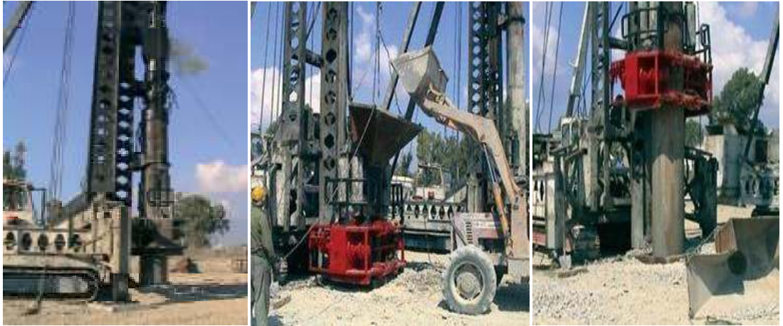
Şekil 2.9 Taş kolon imalatlarında sırasıyla; borunun sürülmesi, çakılın doldurulması ve borunun geri çekilmesi (Nalçakan, 2004).
