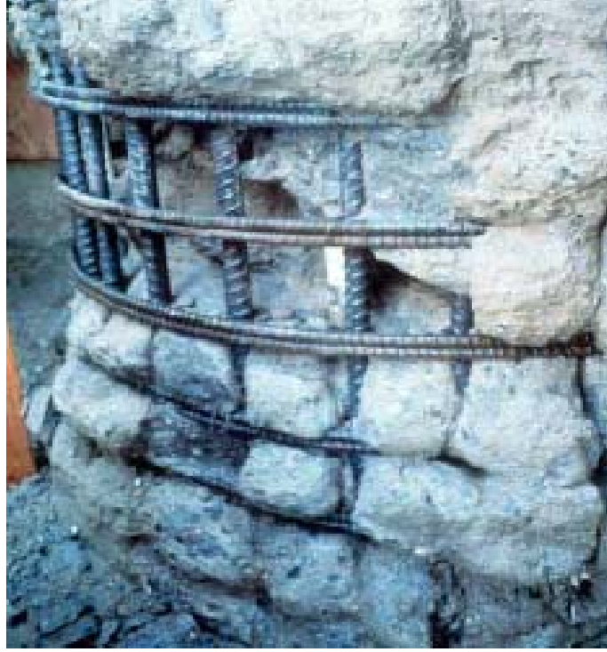
Şekil 1.6 Geleneksel betonun yetersiz sıkışması.
