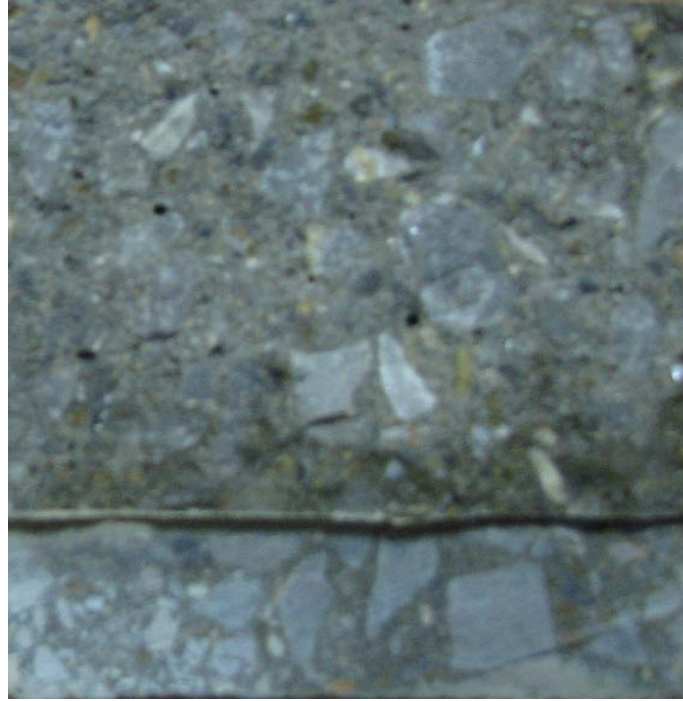
Şekil 8.5 Çatlağın agregaları yarararak ilerlemesi (C00).
