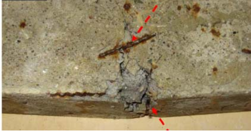
Şekil 4.13 Eğilme yüklemesi yapılan örnekte (gerilme seviyesi %50) yüzeye yakın bölgede korozyona uğrayan çelik liflerin çatlak gelişi mine katkısı (Bassuoni ve Nehdi, 2008).
