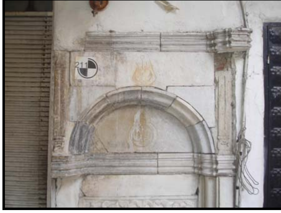
Şekil 5.5 Silmelerde çatlak ve kopmalar (40 no'lu çeşme, 2008)
