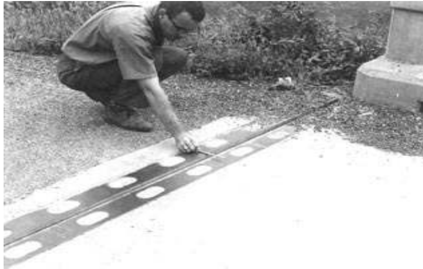
Şekil 2.8 Virginia’da ACR sonucu derzler arasındaki boşlukların kaybolması ( http://www.tfrc.gov/pavement/pccp/petro/chaptr10.htm , 2006).
