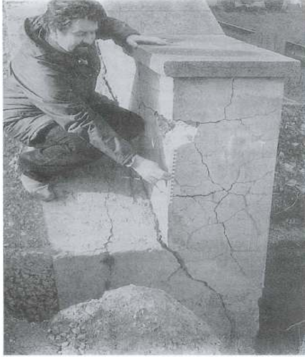
Şekil 2.2 ASR sonucu hasar görmüş bir beton (Hewlett, 2006).
