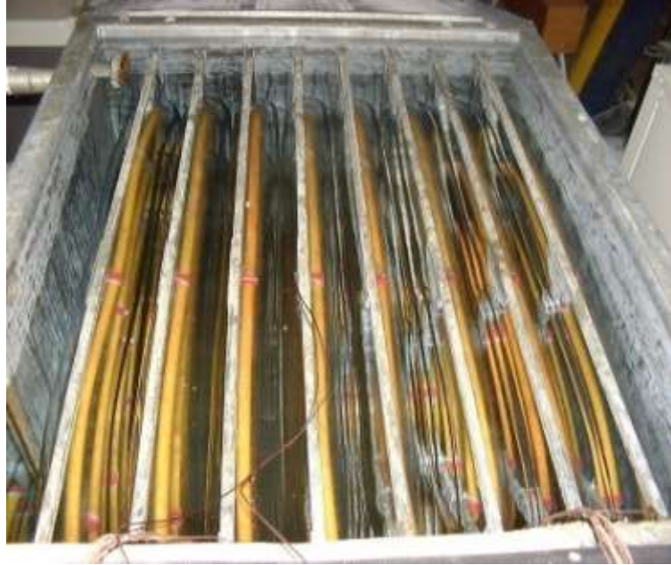
Şekil 4.1 10 saatlik depolama sonunda boru yüzeyinde oluşan buz tabakası
