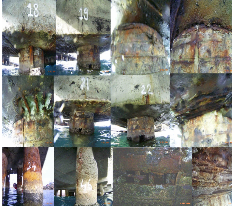
Şekil 5.2 Rehabilitasyon ve güçlendirme gereken kazıklar
