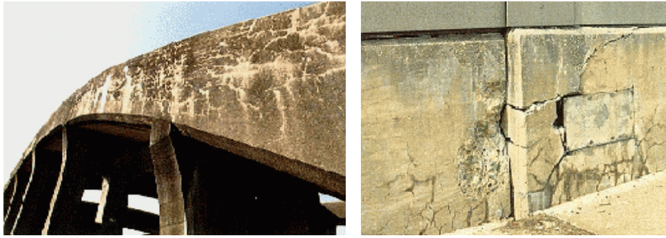
Şekil 3.6 ASR hasarına uğramış yapı örnekleri
