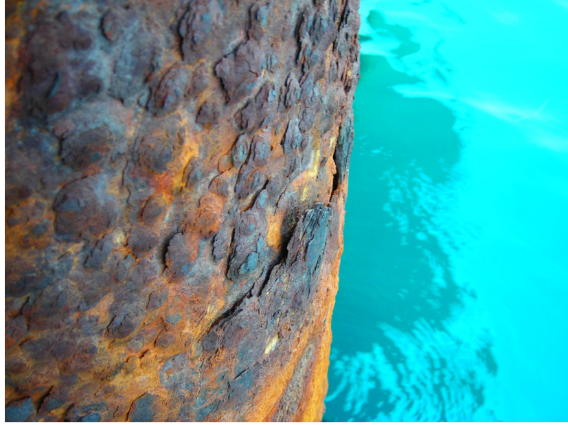
Şekil 5.16 Çelik boru kazıklarda korozyona bağlı pas tabakası
