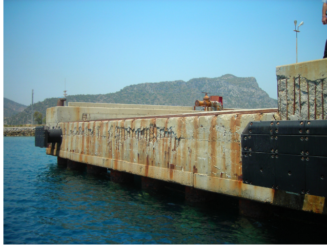
Şekil 5.18 Kapak atma rampası alın kirişlerinde donatı korozyonu
