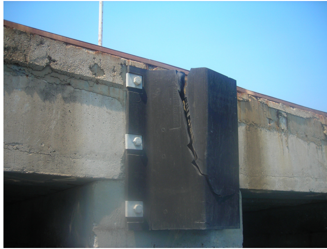
Şekil 5.19 Hasarlı usturmaça örneği
