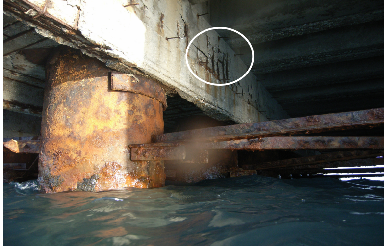
Şekil 5.15 Başlık kirişi betonunda dökülme ve donatılarda korozyon
