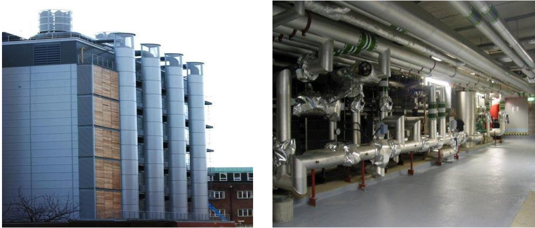
Şekil 3.28 Devonshire Binasının yağmur suyu toplama ve yapı içine dağıtılmasını sağlayan tesisat sistemi ( http://www.greenspec.co.uk/html/imagebank/devonshire.html )
