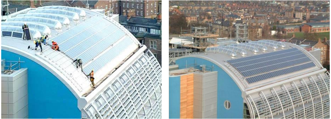
Şekil 3.26 Devonshire Binasının çatısının güneye bakan bölümünde PV panellerin yerleştirilmesi ( http://www.greenspec.co.uk/html/imagebank/devonshire.html )
