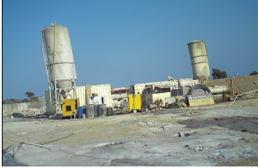
Şekil 5.2 Jet grout çimento silosu, pompa ve santral üniteleri
