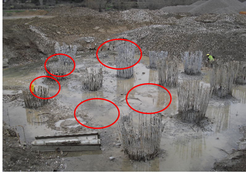
Şekil 8.3 Su boşaltıldıktan sonra yaklaşık 20 adet kazıktan 5 adet kazık donatısının aşağıda bulunan gevşek malzeme içine doğru kaçtığı tespit edilmiştir.
