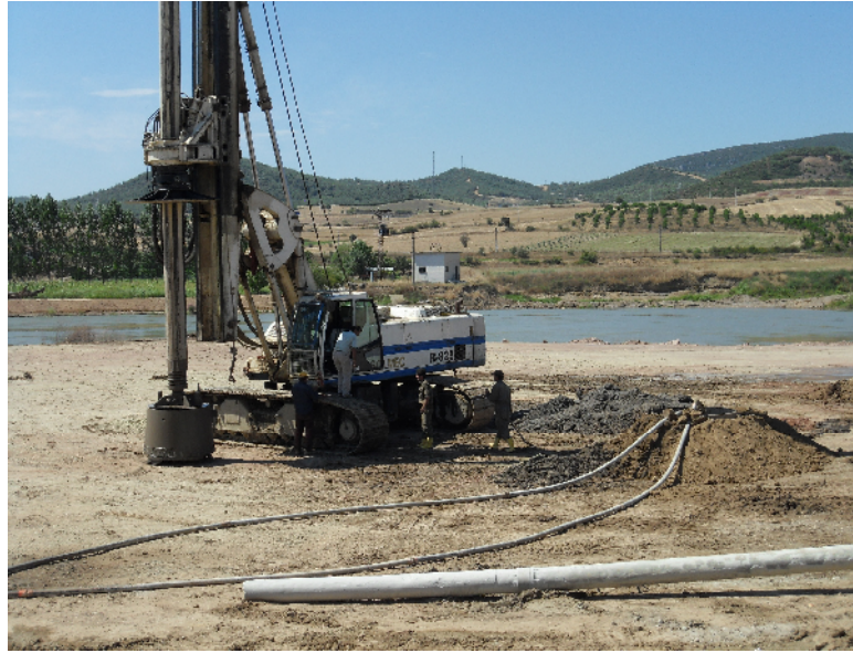
Şekil 6.7 Kurulan platform üzerinde Sakarya Nehri geçişinde fore kazık imalatı ve bage ile foraj yapılması
