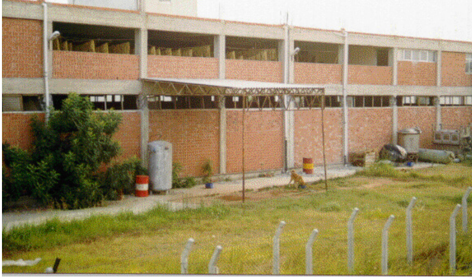
Şekil 2.3 Kısa kolon etkisi ile hasar gören bir yapı, Ceyhan depremi (Çağatay, 2007).
