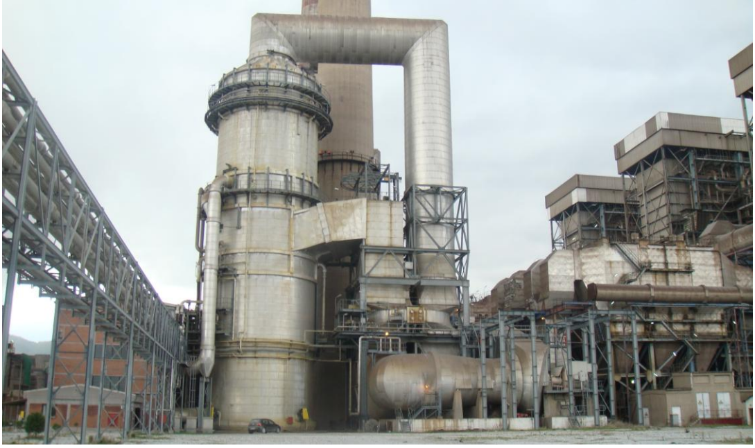
Şekil 1.8 Baca gazı desülfürizasyon ünitesi (YEAŞ, 2010)
