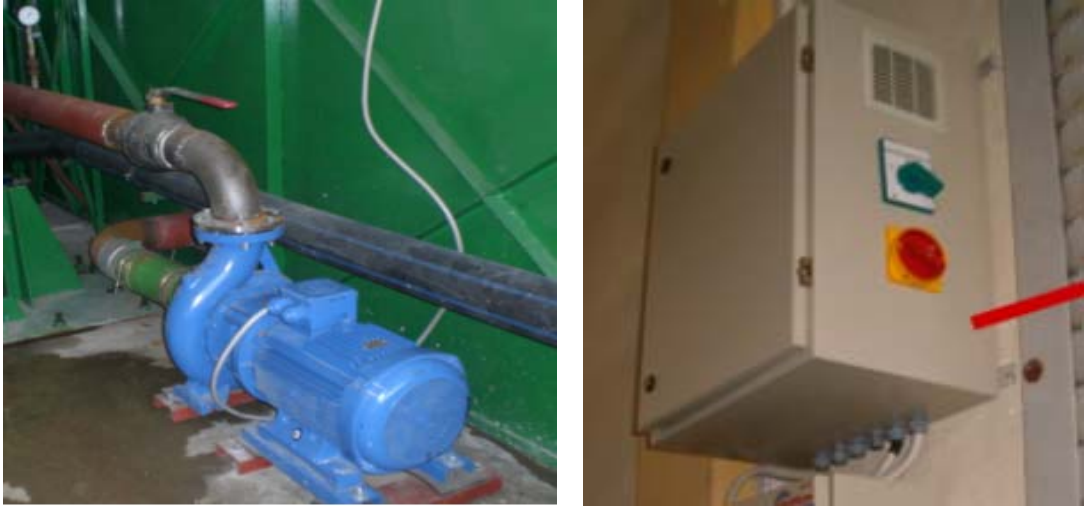
Şekil 3.3 a) 2. basma hattı üzerindeki pompa, ayar vanası ve manometre b) Debi Kontrol Cihazı
