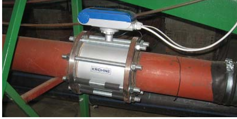
Şekil 3.14 Kanal girişine yerleştirilmiş debimetre
