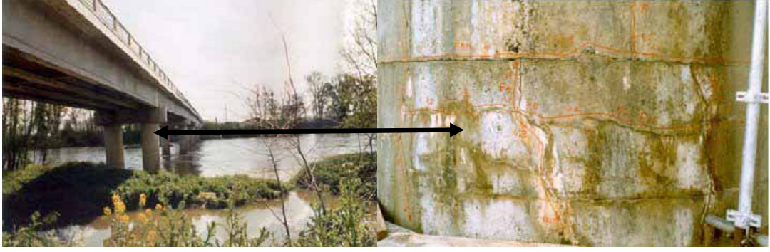
Şekil 3.7 Fransa'da betonarme köprü başlığında meydana gelen hasar (Divet ve Pavoine, 2004).
