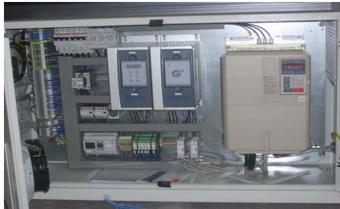
Şekil 3.49 Elektrik panosu ve frekans konvertörleri (Çekim ve düzenleme: M.S.Ç.)
