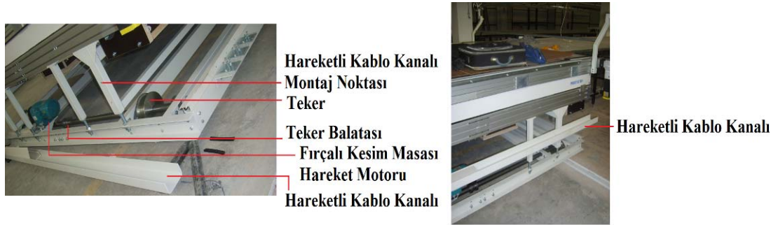
Şekil 3.54 Hareketli kablo kanalı (Çekim ve düzenleme: M.S.Ç.)
