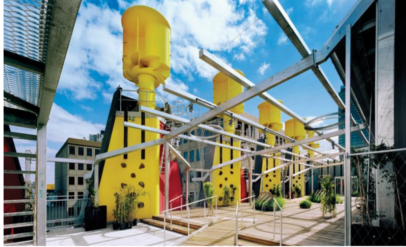
Şekil 4.24 Melbourne Belediye binası çatısında bulunan rüzgar türbinleri ( http://www.designinc.com.au/projects/ch2-melbourne-city-council-house-2 ).
