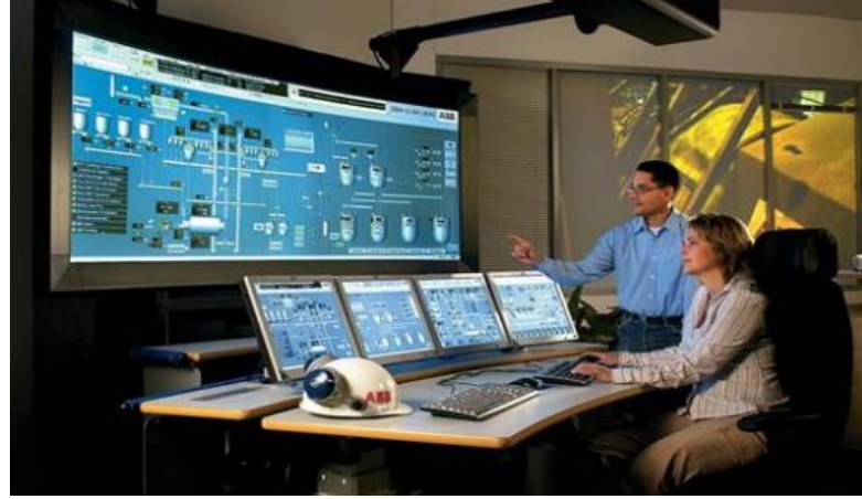
Şekil 1.10 Örnek bir SCADA kontrol merkezi (Yapar ve Tümer, b.t).
