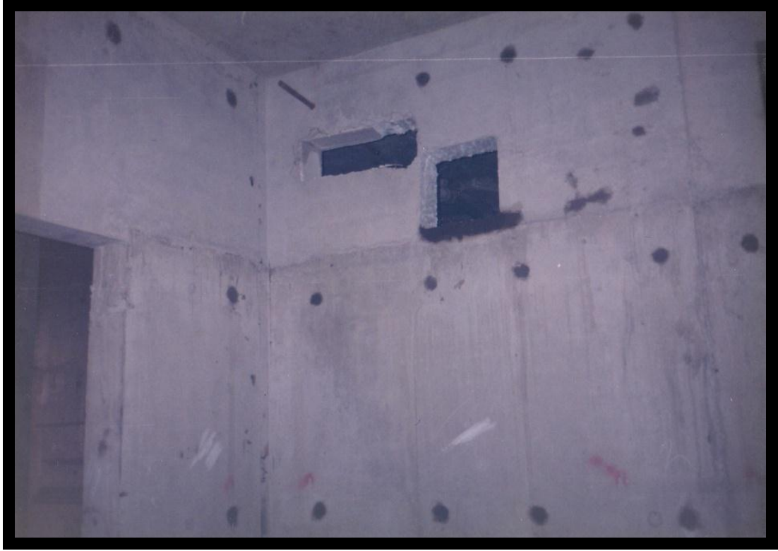
Şekil 3.13 Mavişehir I.Etap Evleri zemin katta oluşan soğuk derz. (Dilek Tezgelen arşivinden,1991).
