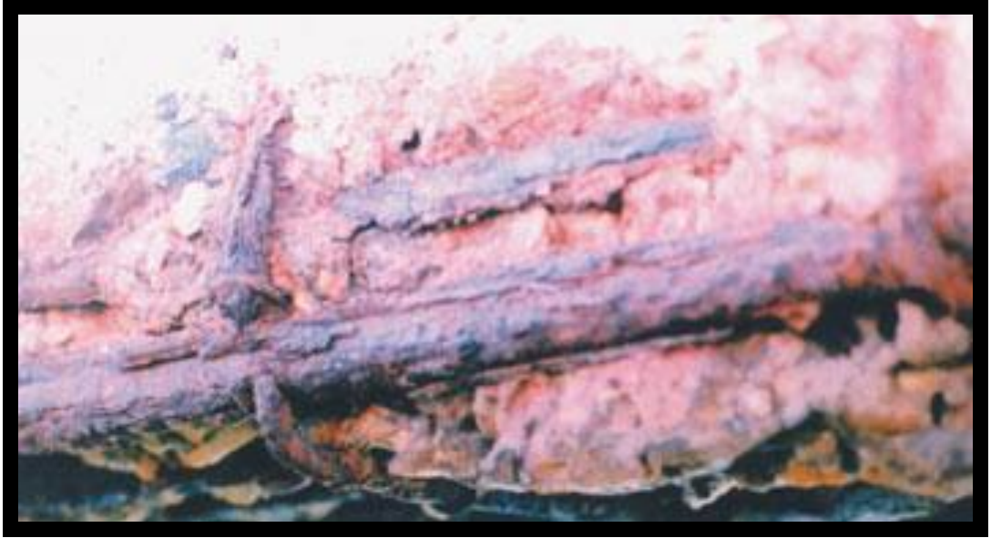
Şekil 2.30 Donatıda oluşan korozyon (TMMOB, 2009)
