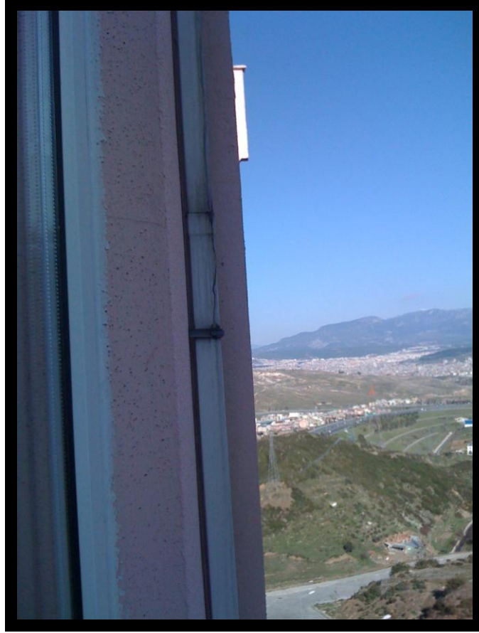
Şekil 4.83 TOKİ Uzundere Konutları Yağmur Boruları
