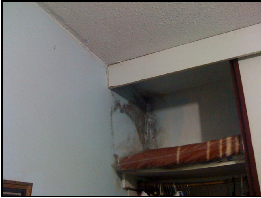
Şekil 4.26 Gaziemir Emlak Bankası Evleri Bodrum Kattaki Görevli Dairelerinde Yaşanan Rutubet Sorunu. (Dilek Tezgelen Arşivi,2012).
