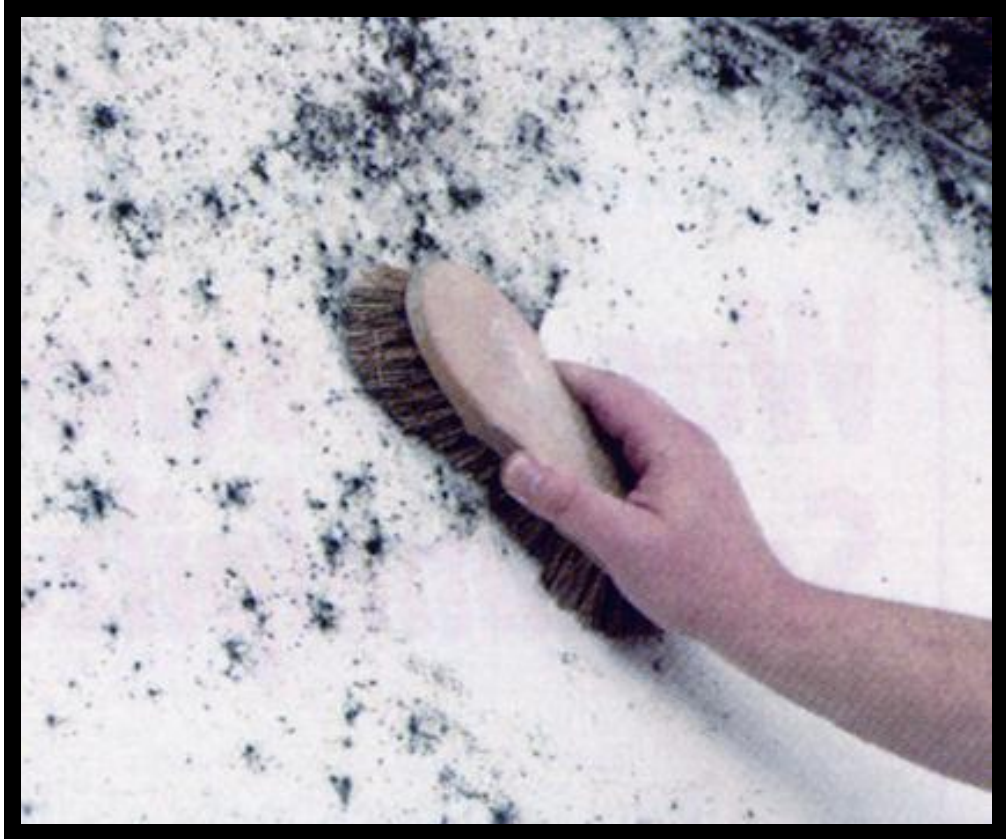
Şekil 2.28 Dış duvarda küflenme (TMMOB, 2009)
