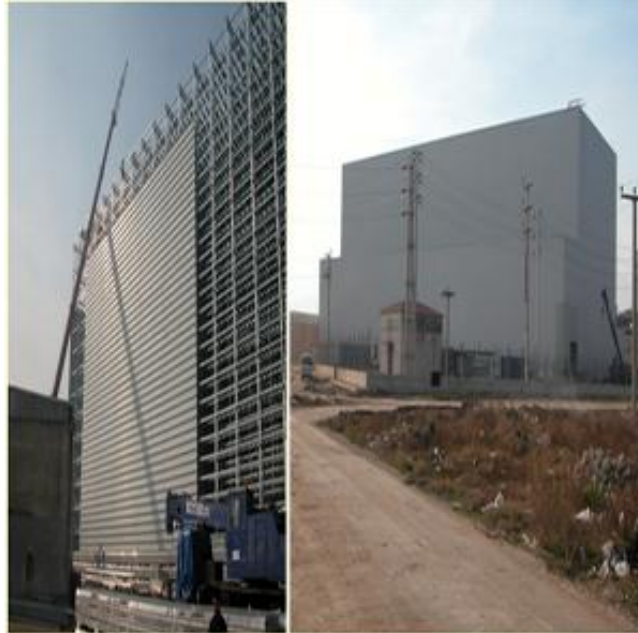
Şekil 3.33 Trapez sac uygulaması. Kaset sistem taşıyıcı + tek kat trapez sac. (İsko – Sanko Hold. Teknoloji Lojistik Depo İnegöl / Bursa http://www.artikelmuhendislik.com )
