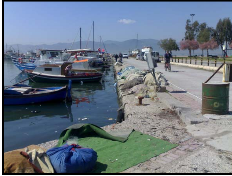
Şekil 5.36 Ortalama +0.65 m üst kotundaki rıhtım hattı (onarım öncesi).
