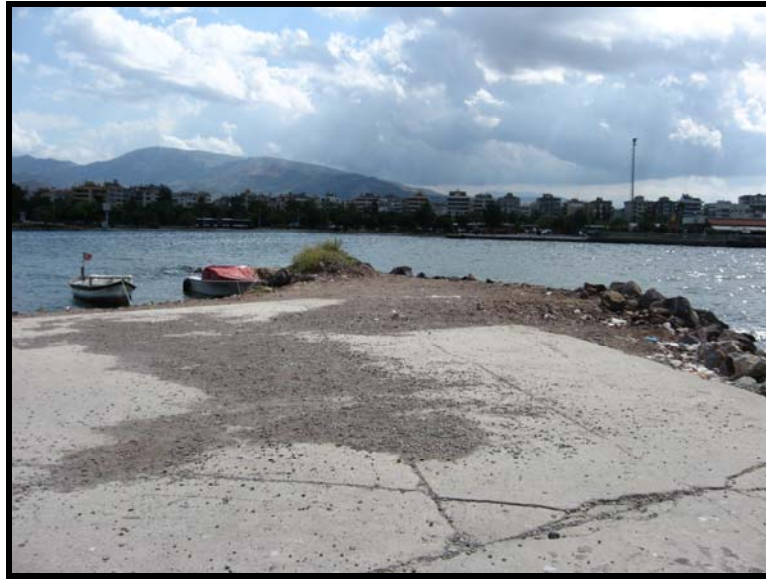
Şekil 5.33 Müzvar kısmı (onarım öncesi).
