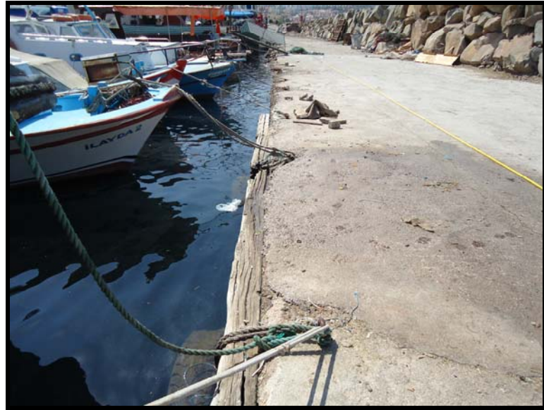
Şekil 5.5 Ortalama üst kotu +0.20 m olan rıhtım (onarım öncesi).
