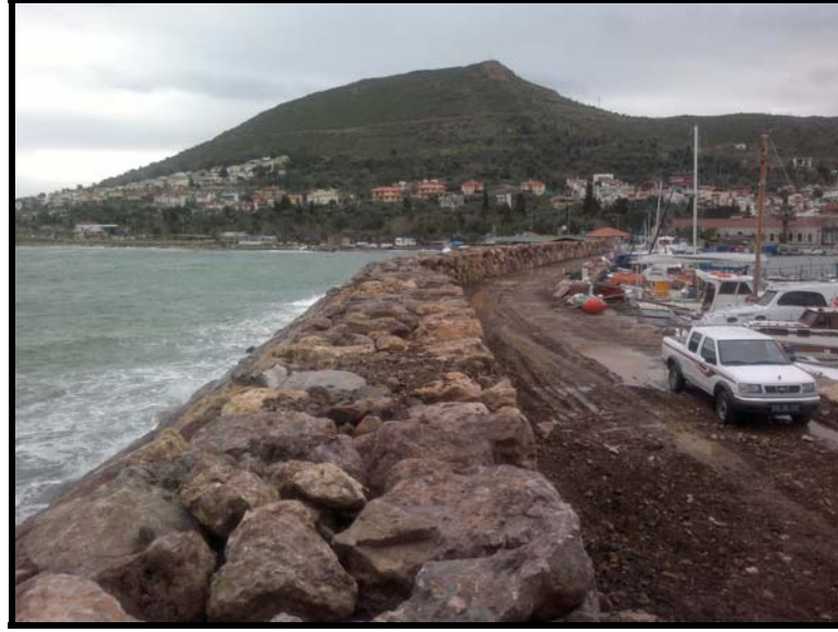
Şekil 5.28 +3,00 m üst kota sahip mendirek (onarım sonrası).
