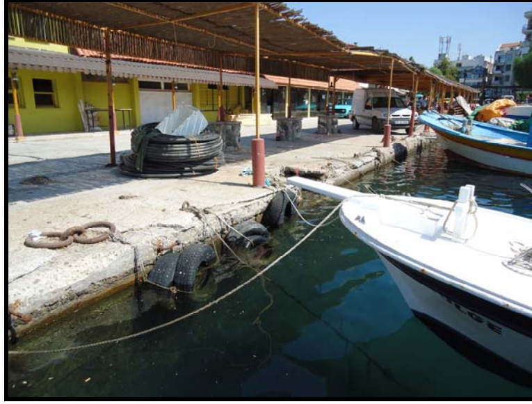
Şekil 5.6 Ortalama üst kotu +0.35 m olan rıhtım (onarım öncesi).
