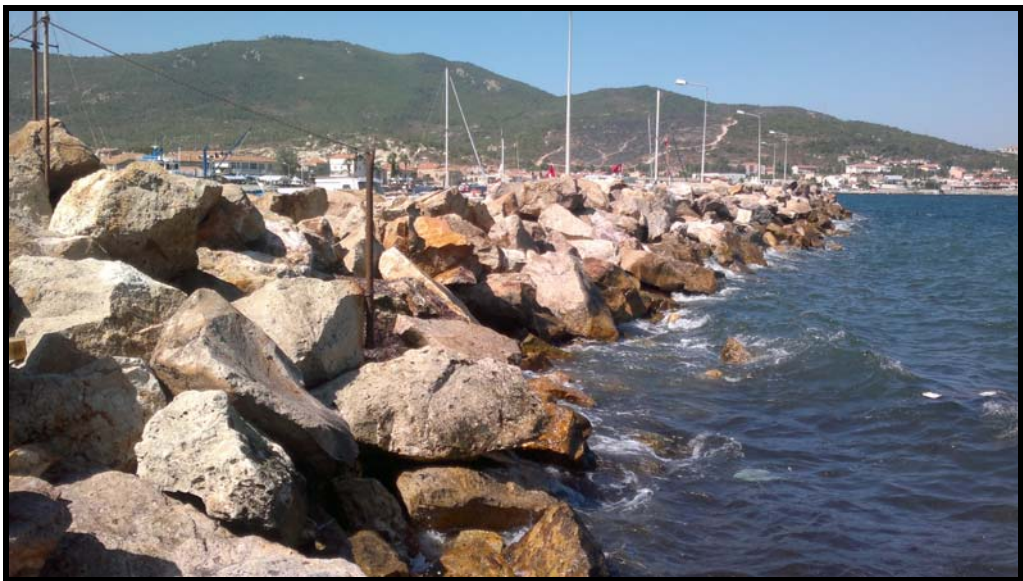
Şekil 5.27 Mevcut mendirek (onarım öncesi).
