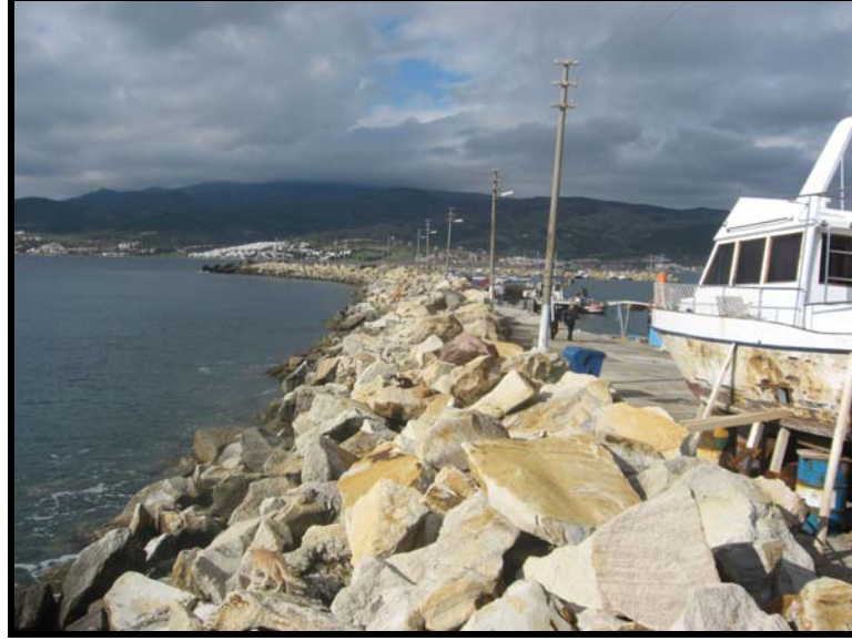
Şekil 5.15 Bozulmuş formdaki mendirek (onarım öncesi).
