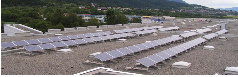
Şekil 2.19 Düz Çatı üzerine fotovoltaik panel uygulaması, Avusturya (Pvdatabase, bt.)
