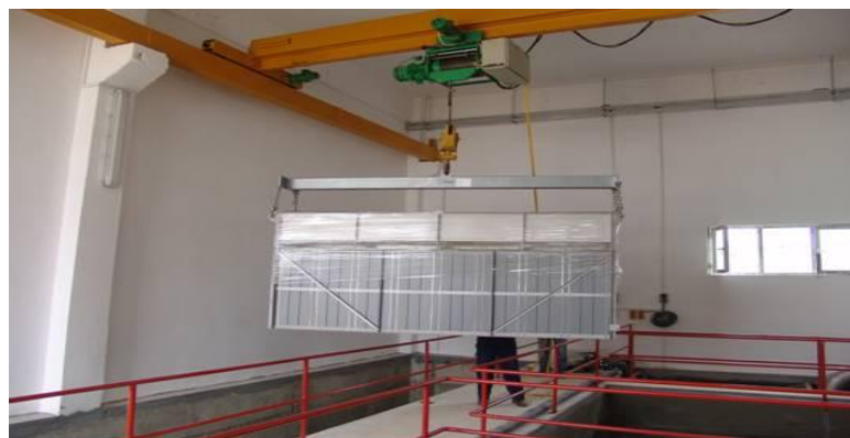
(d) MBR Cassette of Konacik Municipal WWTP
