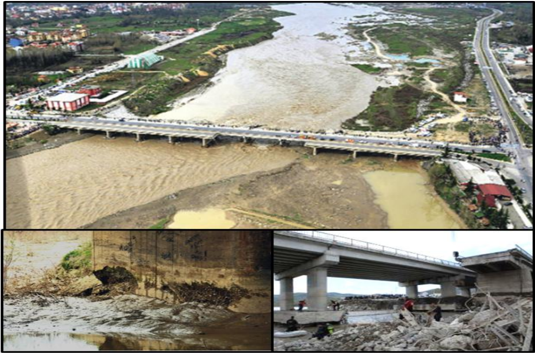
Şekil 2.1 Nisan 2012’de Zonguldak Çaycuma Filyos Çayı’ndaki köprünün şiddetli sel yüzünden yer değiştiren kum çukurlarının köprünün kazık sisteminin altını 5 metreye kadar oyması sebebiyle çökmesi sonucu köprü üstündeki 1 otomobil ve 1 minibüs suya gömüldü. (Aktif haber,2012)
