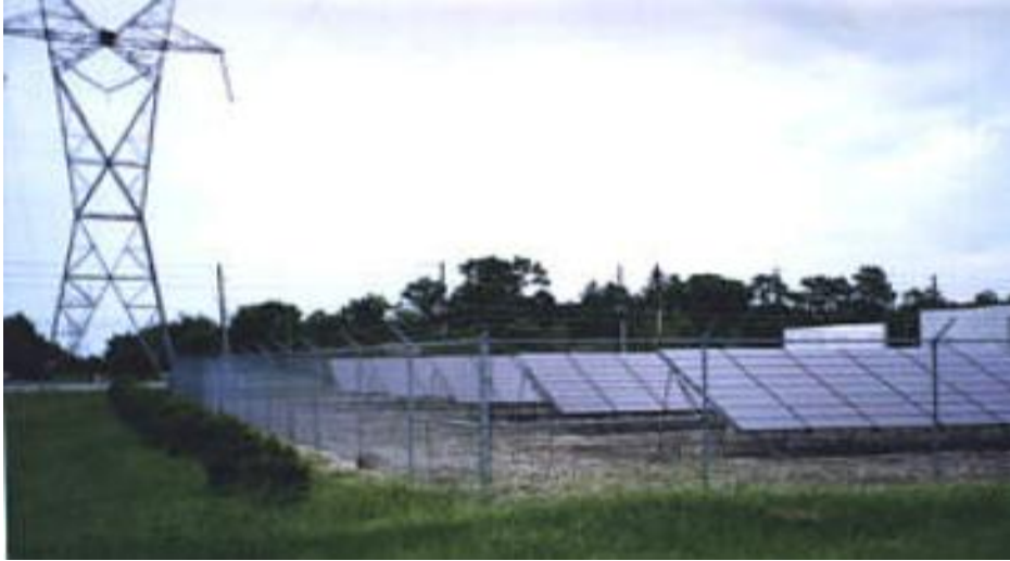
e) Şebekeye elektrik veren güneş pili sistemi
