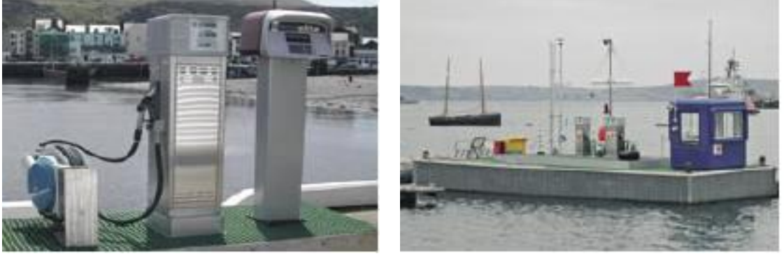
Şekil 34:Marina Akaryakıt Tesisi
