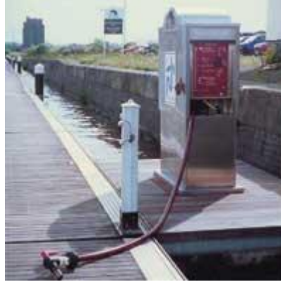
Şekil 35: Atık Alım İstasyonu
