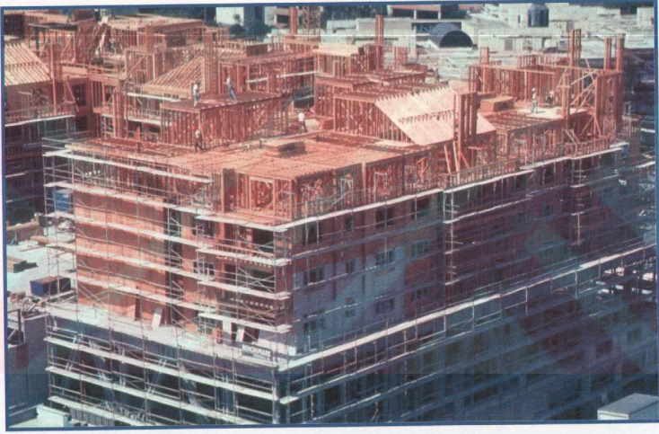
Şekil 3.76 Karma Sistem-Betonarme ve çelik alışveriş merkezi, otopark katları ve ahşap karkas konut katları, inşaat aşaması. A.B.D. (Erdoğan, E., arşivi U.A.B başkanı)
