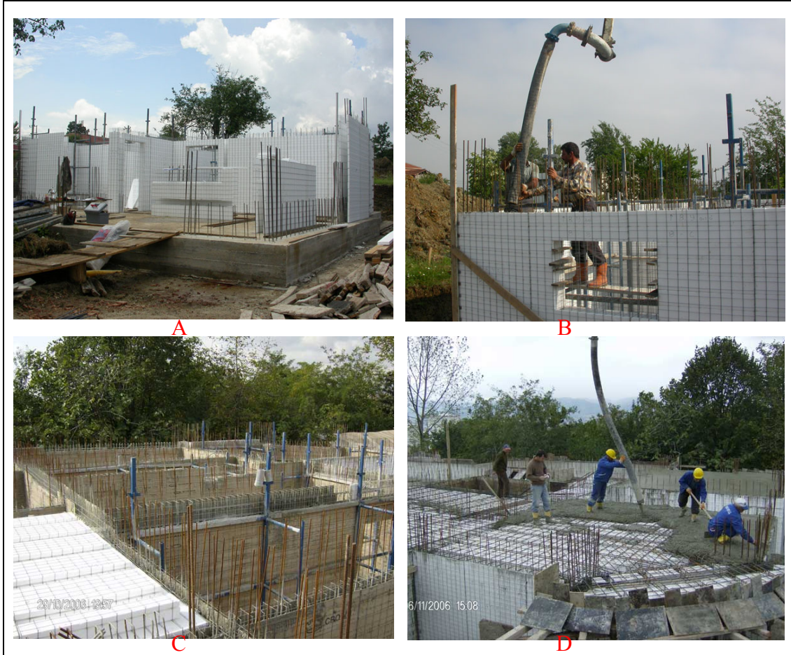
Şekil 4.8 Subasman üzerine duvar panellerinin yerleştirilmesi (A) ve duvarların betonlanması (B), döşeme panellerinin hazırlanması (C), döşemenin betonlanması (D).
