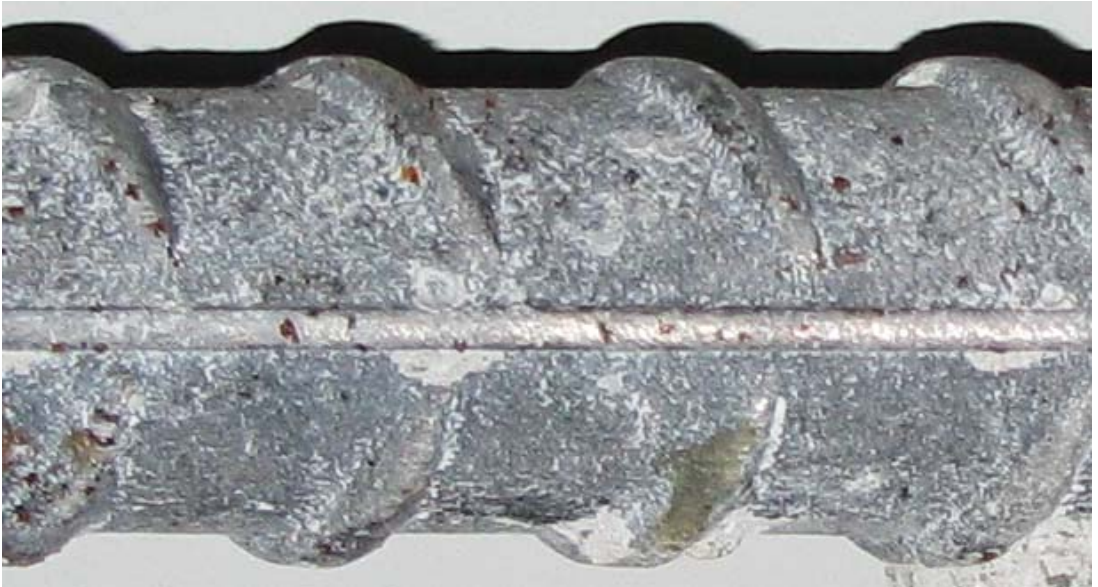
Şekil 10.10 Donatı yüzeyinde gelişen çukurcuk (pitting) korozyonu.
