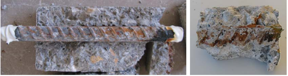
Şekil 10.15 Epoksi kaplamadaki delik sebebi ile donatı-beton ara yüzeyine sızan klorür çözeltisinin oluşturduğu korozyon.
