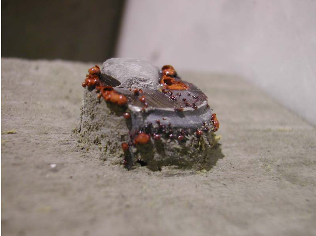
Şekil 6.14 Açıkta kalan çelik donatı (7. günde, temizleme işleminden önce).
