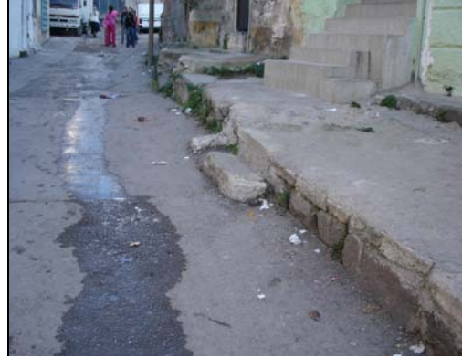
Şekil 5.38 953 Sokakta 20 numaralı evin altında, kısmen beton ile kaplanmış antik döşeme kalıntısı konumlanmakta ve sokak boyunca devam etmektedir.
