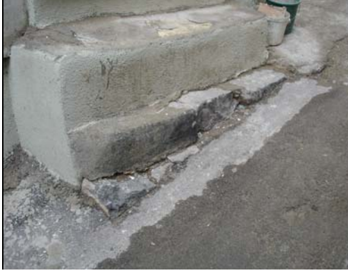
Şekil 5.25 972 Sokak'ın doğu-batı doğrultusunda konumlanan kısmında, 15 numaralı evin altında konumlanan döşeme kalıntısı sokak boyunca devam etmektedir.
