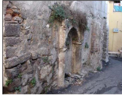
Şekil 5.34 970 ve 952 Sokakların köşesinde 2 numaralı evin altında, eski bir su yapısına ait olabileceği düşünülen kalıntılar bulunmakta, cephesinde destek duvarları, künk kalıntıları ve çeşme yer almaktadır.
