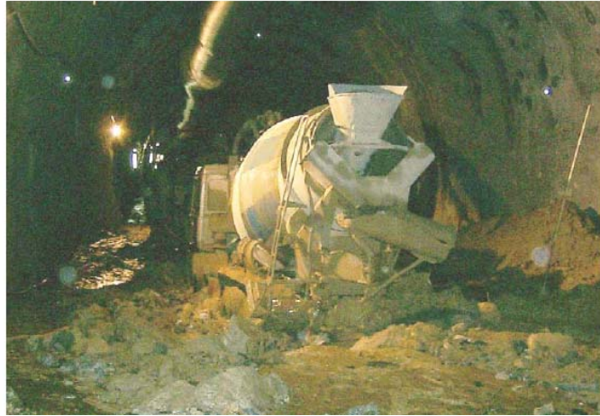
Şekil 3.7 Blisadona Tünel' i içerisine gözlenen büyük ölçekli su geliri. (Avusturya)
