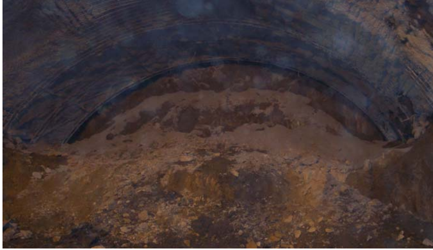
Şekil 3.8 İzmir Metrosu Üçyol-Üçkuyular hattı istasyon tüneli kazısında meydana gelen ayna akması (Türkiye)
