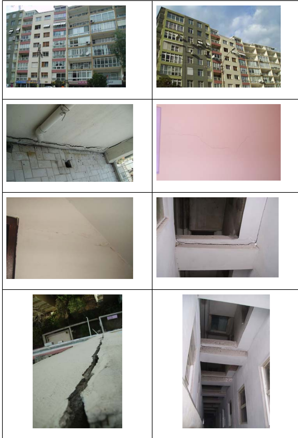
Şekil 6.4 Güzargah üzerindeki üst yapılarında oluşan çatlaklar ve diklikten sapsmalar
