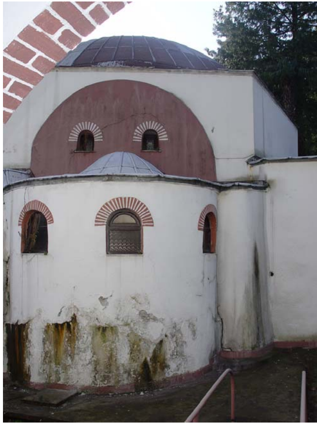
Şekil 4.21 Valide Banyo, cephelerde izlenen bozulmalar
