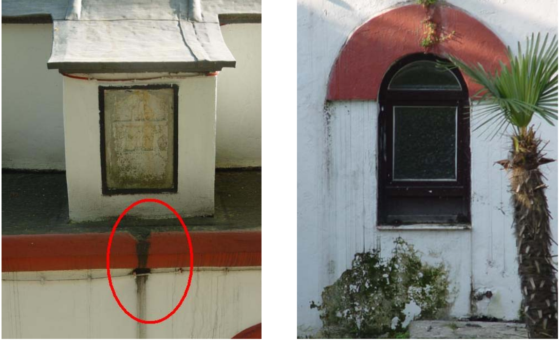
Şekil 4.17 Kurşunlu Banyo'nun cephesinde görülen bozulmalar
