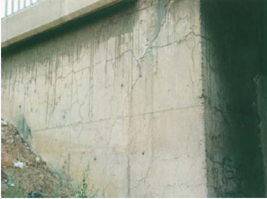
Şekil 2.1 ASR hasarına uğramış köprü ayağı (Baradan, 2002).
