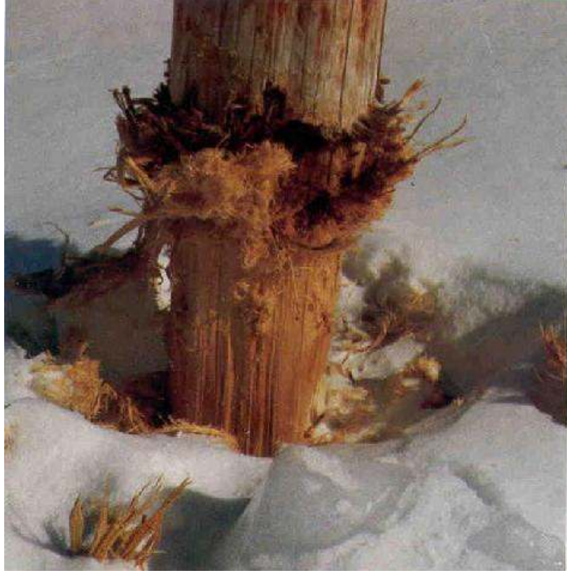
Şekil 4.4. Tahribata uğramış ahşap iskele ayağı
