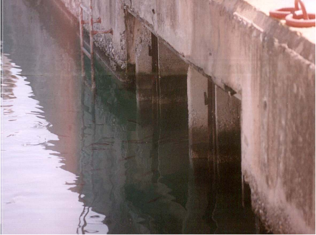
Şekil 4. 1 Turgutreis yat limanında sabit iskelede su geçiş kanalı.
