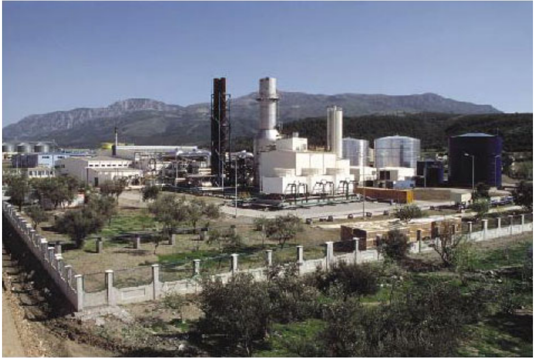
Şekil 5.14 Birleşik elektrik ve ısı üretim santrali, 154 kv enerji nakil hattı ve trafo merkezi.
