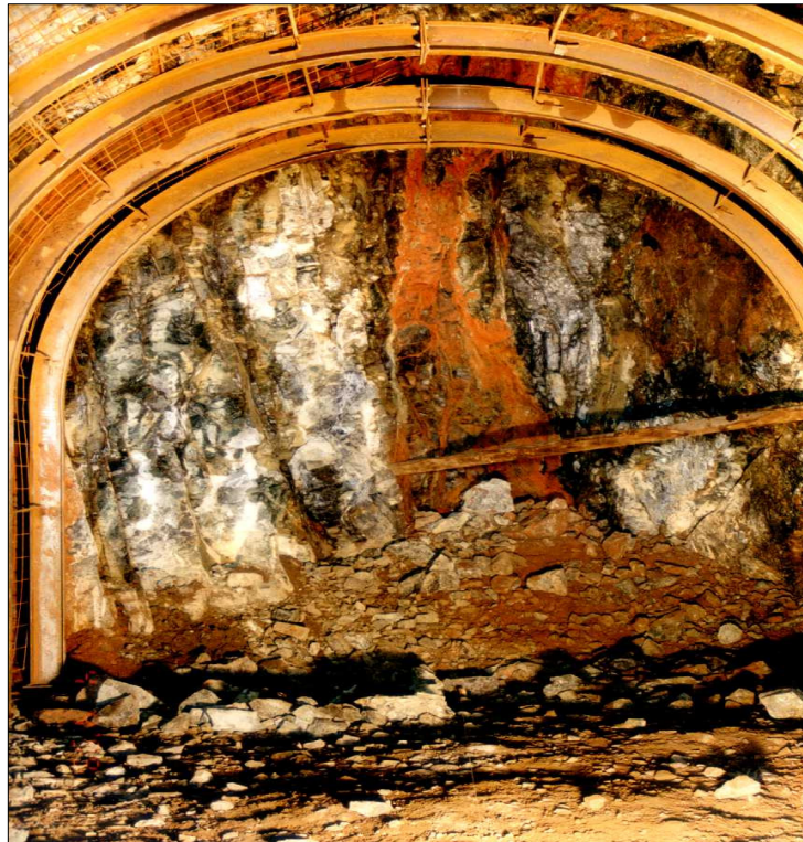
Şekil 5.12 Derivasyon tünel kazısından bir görünüm. Aynada serpantinize dünit birimlerindeki yoğun kırıklı yapı ve çatlaklar arasındaki kil dolgusu görülmektedir.
