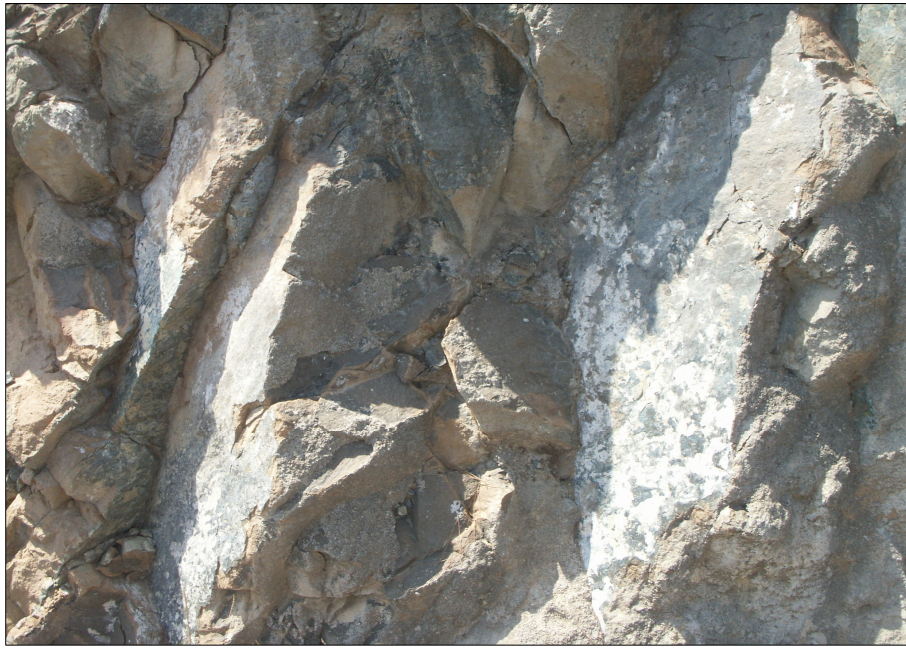
Şekil 6.3 Baraj yeri kayasından ve süreksizliklerinden bir görünüm (sol sahil). Düzlemsel kayma şeklinde şev duraysızlıkları gözlenmektedir.
