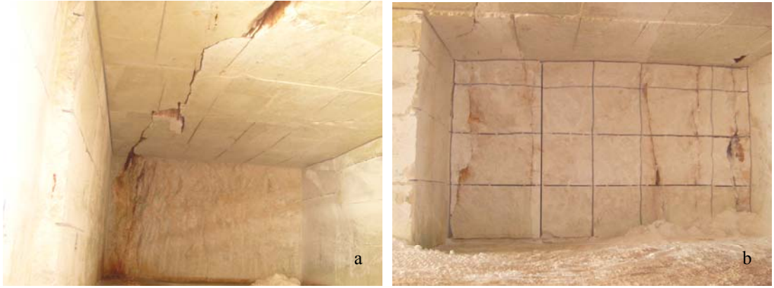
Şekil 4.9 Bir nolu galeri; a), b) Kırık ve çatlaklar.
