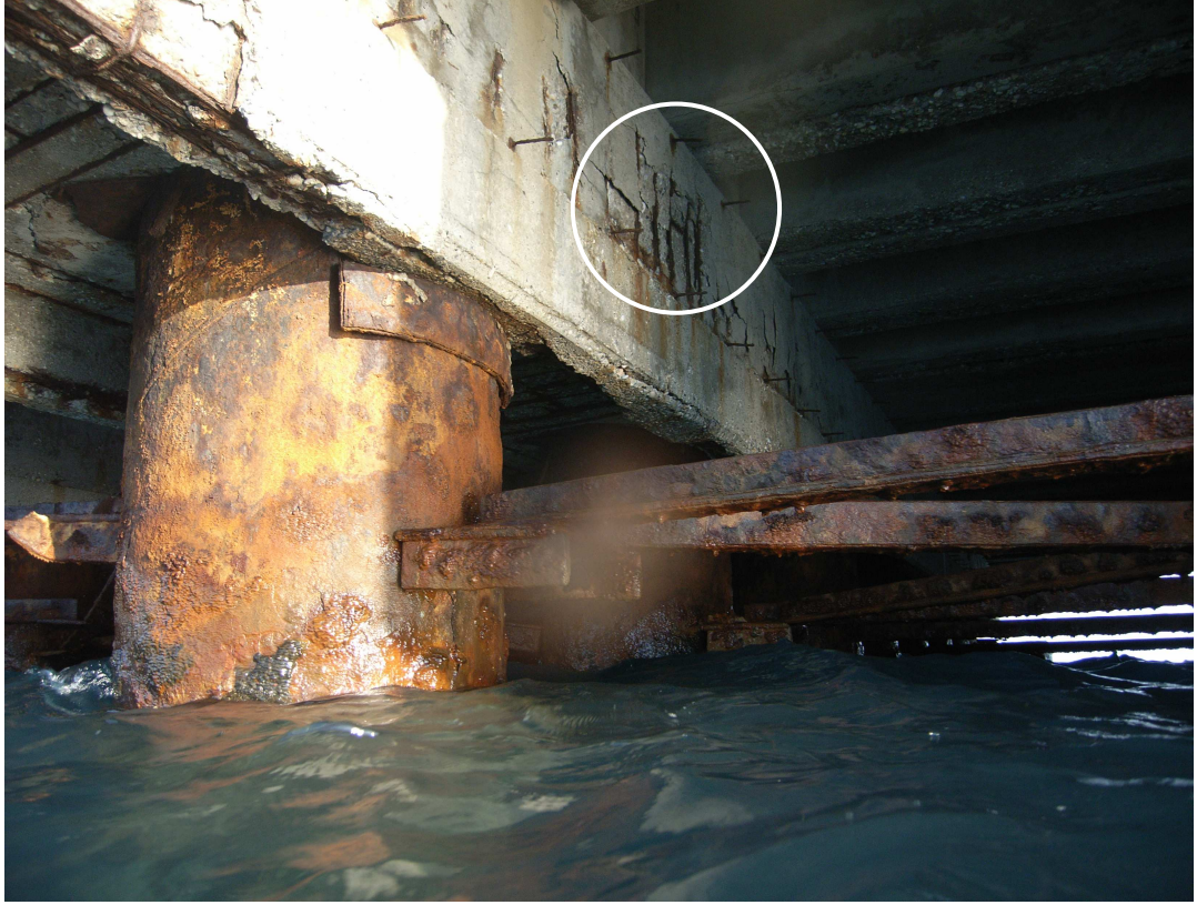
Şekil 4.7 Başlık kirişlerinde beton yüzeyinde dağılma ve donatılarda korozyon
