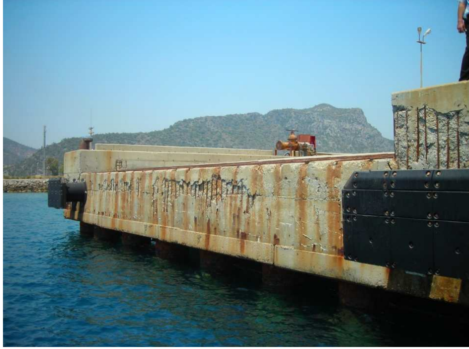
Şekil 4.10 Kapak atma rampası alın kirişlerinde donatı korozyonu
