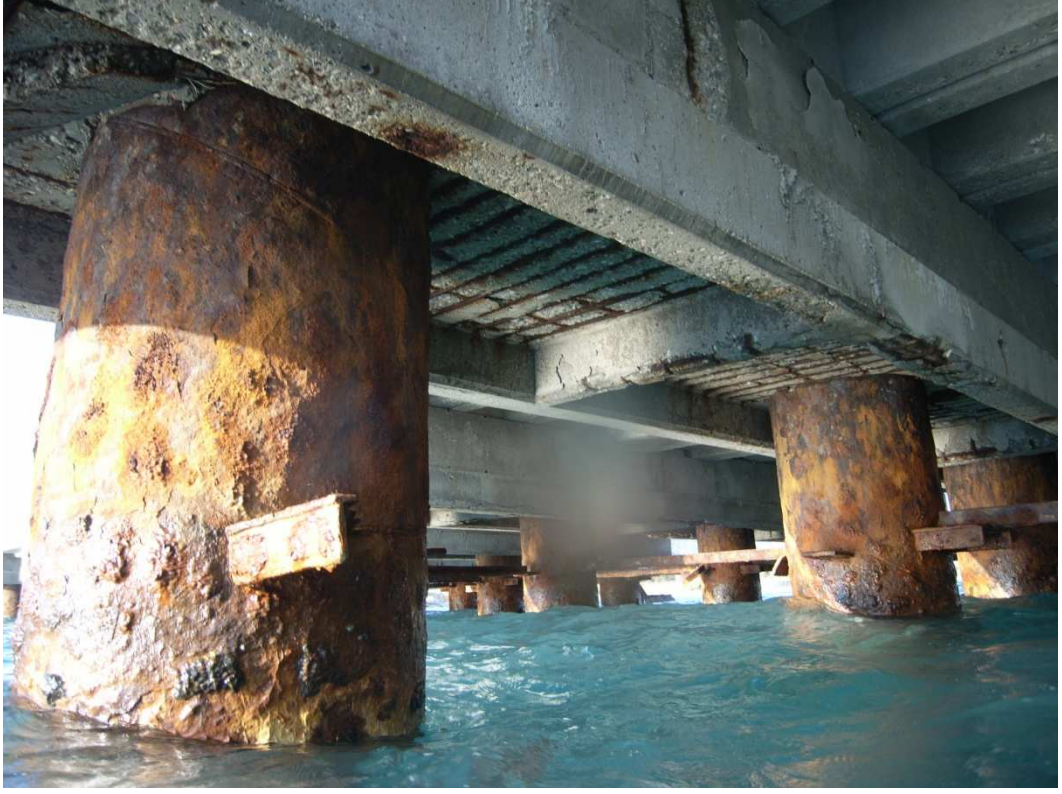
Şekil 4.8 Kazıkların çelik boru muhafazalarında çırpıntı bölgesinde gözlenen korozyon
