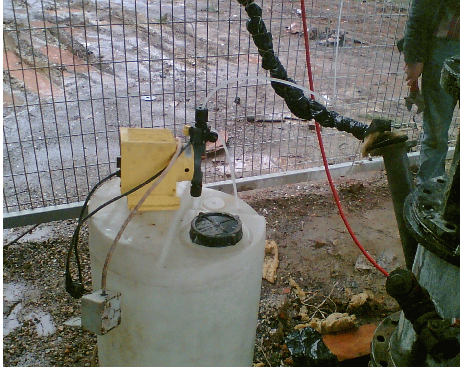
Şekil 5.11 İnhibitör dozaj pompası ve inhibitör tankı
