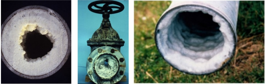
Şekil 5.10 Borularda oluşan kabuklaşma (www.geokem.co.nz)
