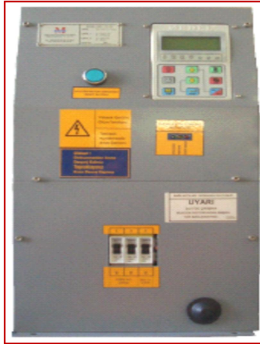
Şekil 2.5 İnverter ünitesinin genel görünüşü.
