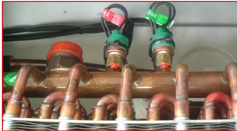
Şekil 1.26 Klima sisteminde alçak basınç ve fan kontrol otomatığı montaj yerinin genel görünüşü.
