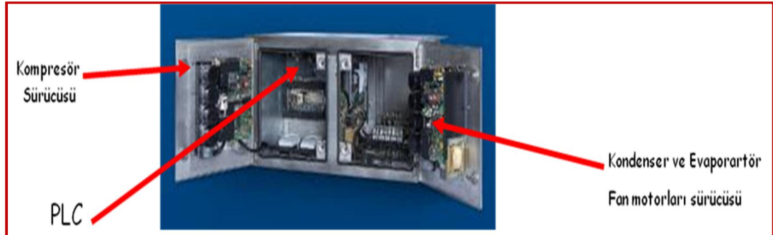
Şekil 2.3 Statik konvertör ünitesinin genel görünüşü.
